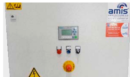
Skříňový rozvaděč se SIEMENS SPS-řízením
